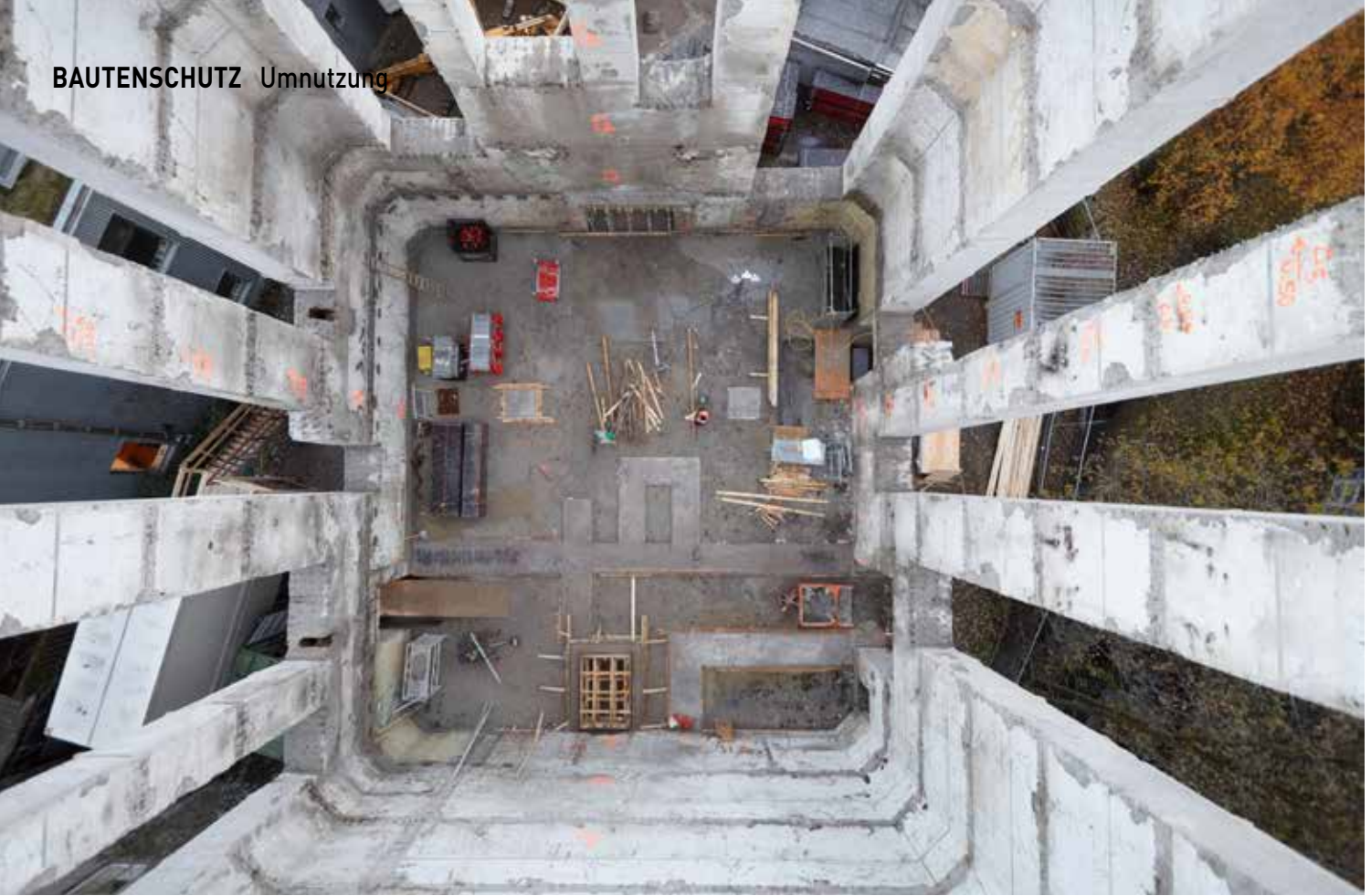
Blick von oben in den ausgehöhlten und aufgeschnittenen Bunker: am Ende blieben acht relativ schmale Wandstücke wie sehr hohe, schmale Pfeiler stehen Foto: Sebastian Schröder
