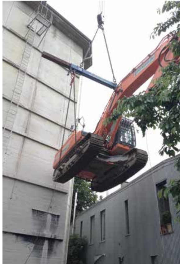
Für den Abriss wurde ein 40t-Bagger von einem 220t-Kran auf das Dach des Bunkers gehoben, um dessen Inneres von oben nach unten abzutragen
