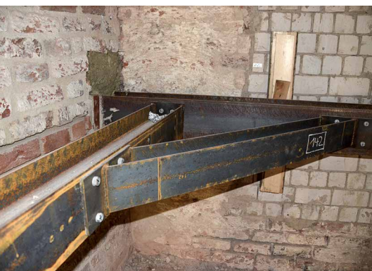
Abb. 34: In der Bauphase wurden die Außenwände mit einem Stahlgürtel auf drei Ebenen gehalten [© Cornelius Back]
