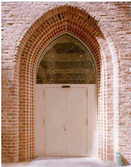
Abb. 20: Das verbaute gotische Portal wurde nach Befund wiederhergestellt [© Konermann Sigmund Architekten BDA Stadtplaner / Alexander de Cuveland]
